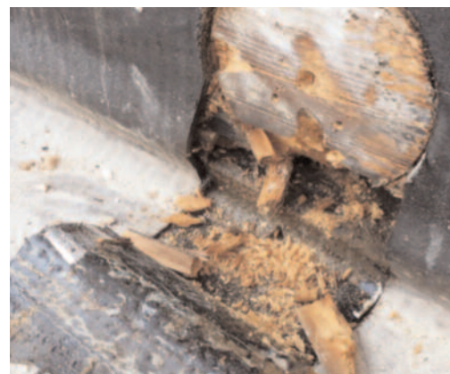
Marcimento della base di una parete in X-Lam di una scuola di 7 anni.
